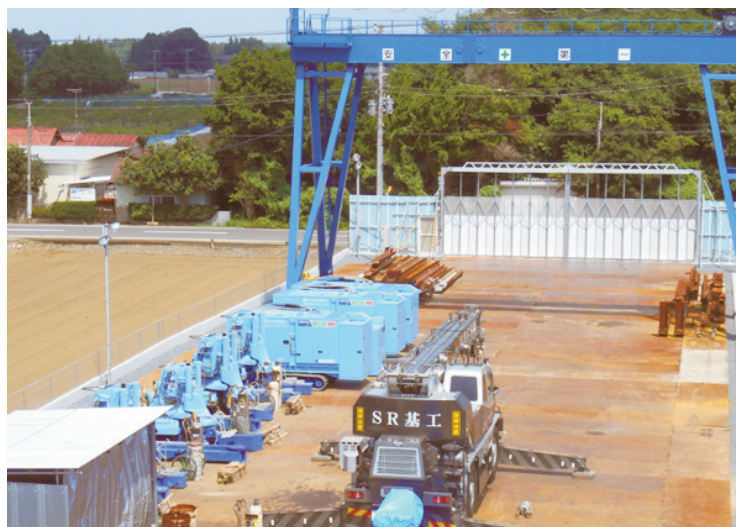
(株)SR基工 圧入機置場
